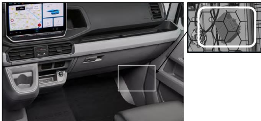
Svorkovnice (IS1) za obložním A-sloupku, dole
